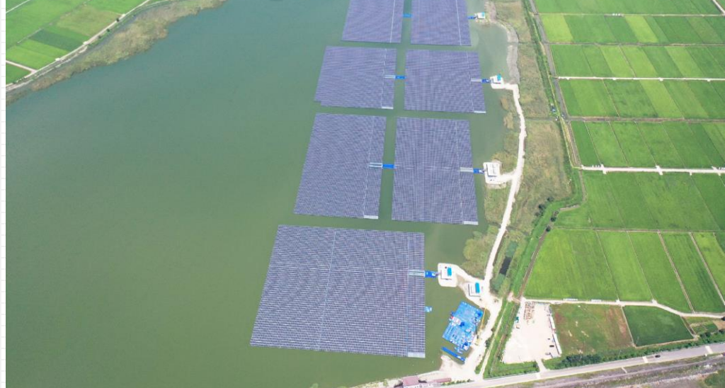
2020 г., Южная Корея, озеро Namjeong, плавающая ФЭС, 25 МВт
