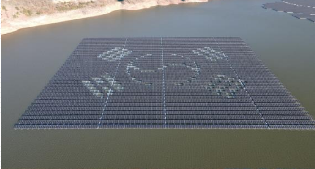
2024 г., Южная Корея, плотина Им-ха, плавающая ФЭС, 47 МВт
