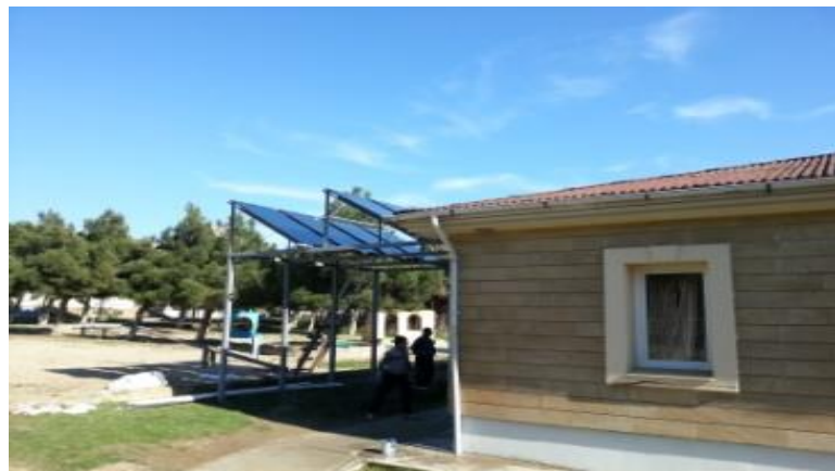
Детская школа SOS (20 кВт электроэнергии, 44 кВт отопление)
