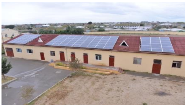
Интернат в Туркане (25 кВт электроэнергии)
