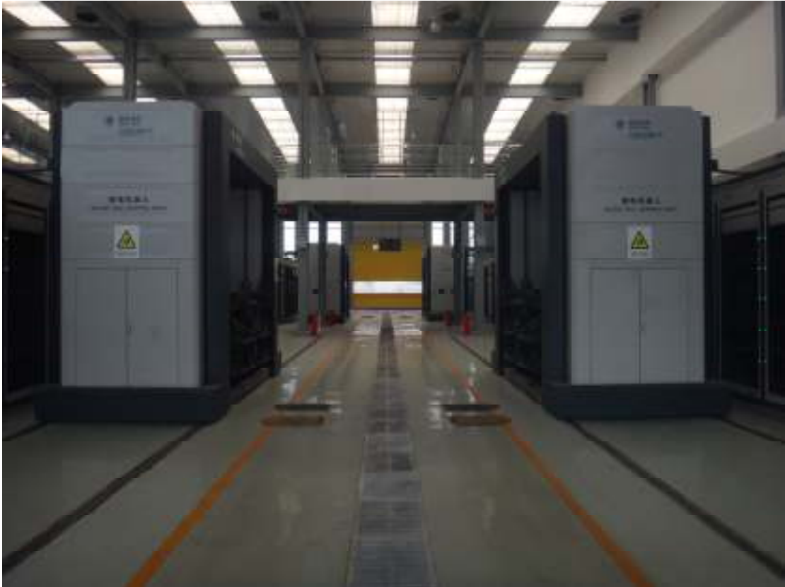
图：四惠电动汽车充换电站换电车间
