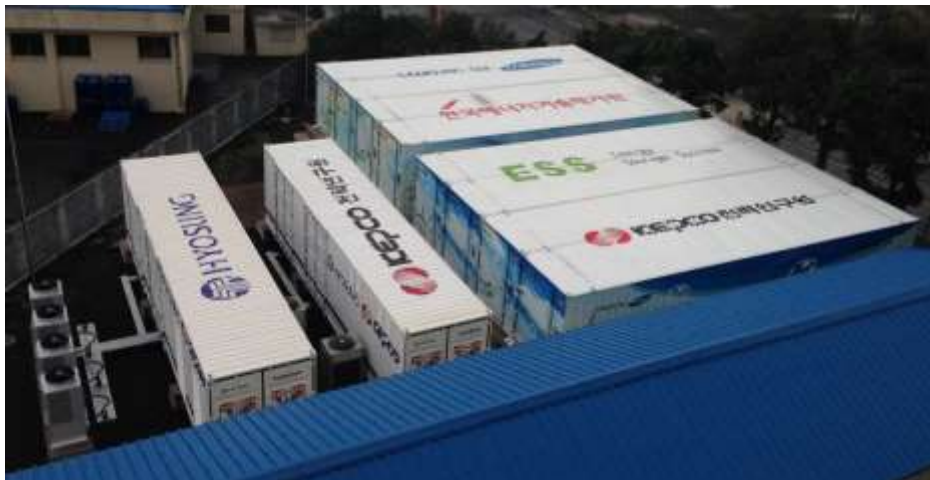
[4MWt/8MWh/ч ESS подстанции в Жезу]
